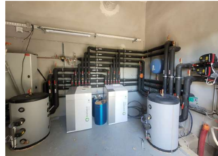
Chaufferie lieu Hybride
