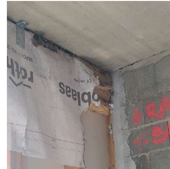
Pare-vapeur et isolant détériorés
