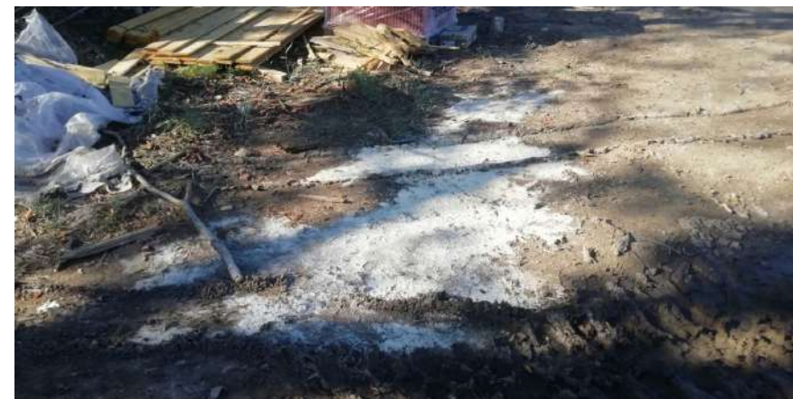
Présence de Laitance de béton
