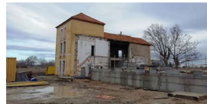
Infrastructure du bâtiment neuf
