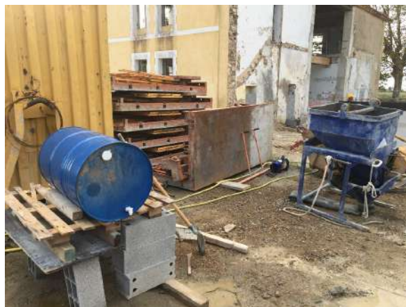
Pas de zone de stockage de l'huile de décoffrage
