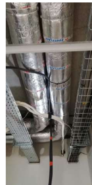
Réseaux aérauliques identifiés et calorifugés
