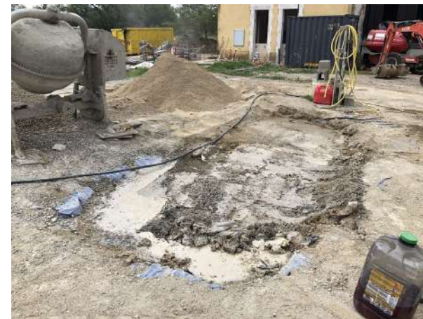
Zone de décantation des eaux de lavages du béton non entretenue
