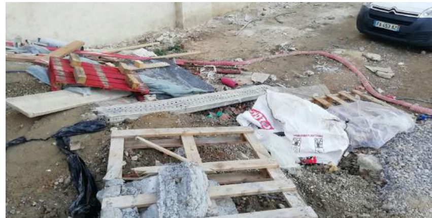
Problématique de propreté de chantier extérieur
