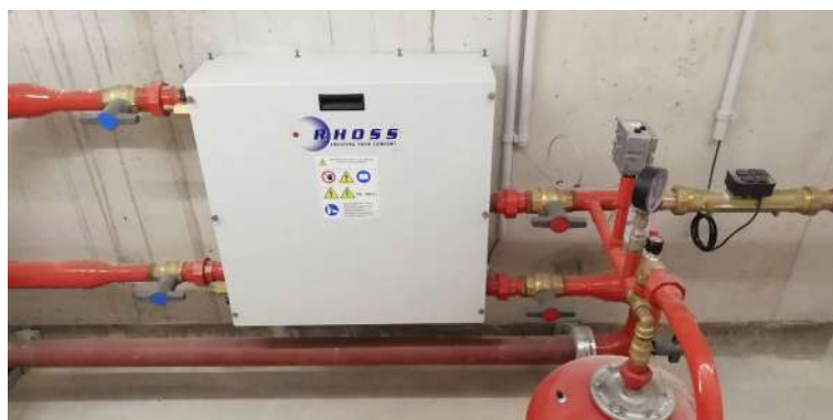
Echangeur de chaleur
