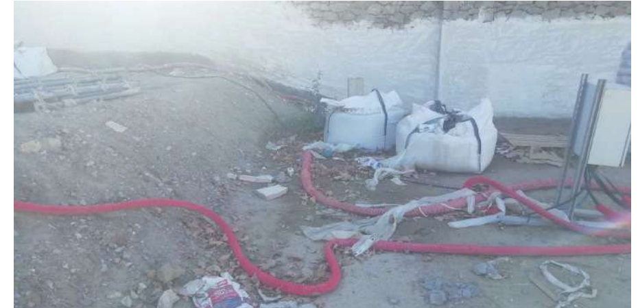
Problématique de propreté de chantier extérieur
