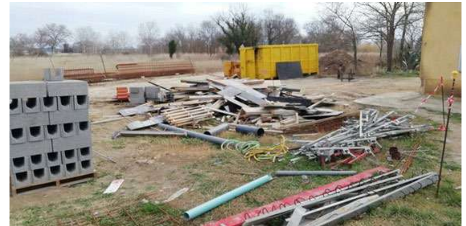
Problématique de propreté de chantier extérieur
