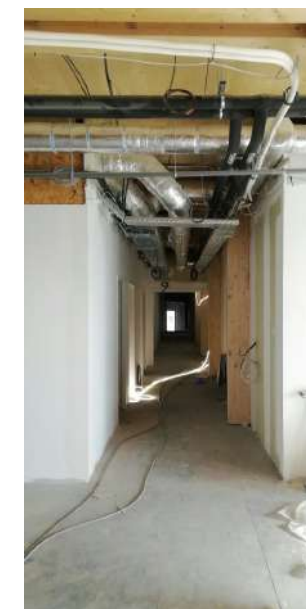
Réseaux hydrauliques calorifugés
