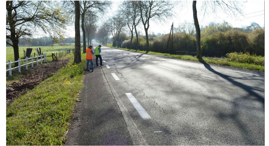
Le phénomène de retrait-gonflement-des argiles fissure les routes (Cerema).
