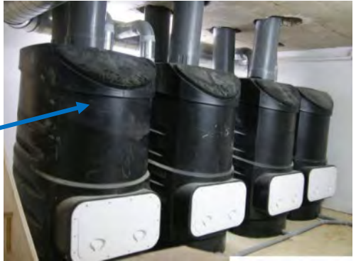
- Composteur en sous-sol
