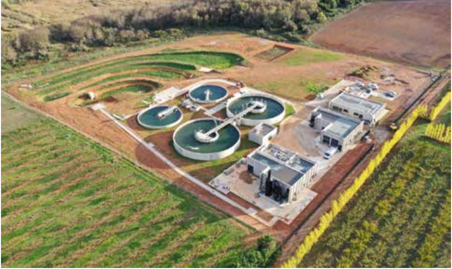
Vue aérienne de la STEU pendant la phase chantier | © AB Sud Ingénierie
