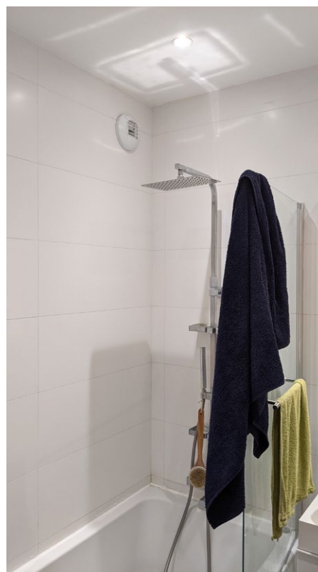
Une bouche d'aération déplacée près du pommeau de douche
