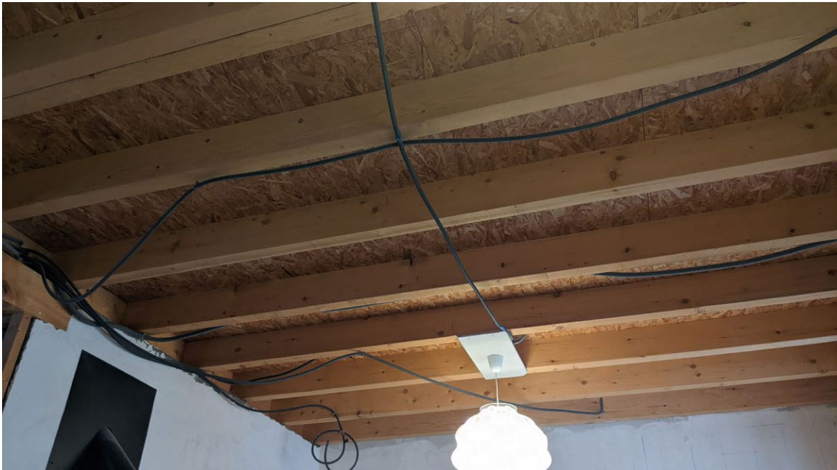
Une maison encore en travaux, le manque de placage au plafond qui émet des polluants à travers le bois collé
