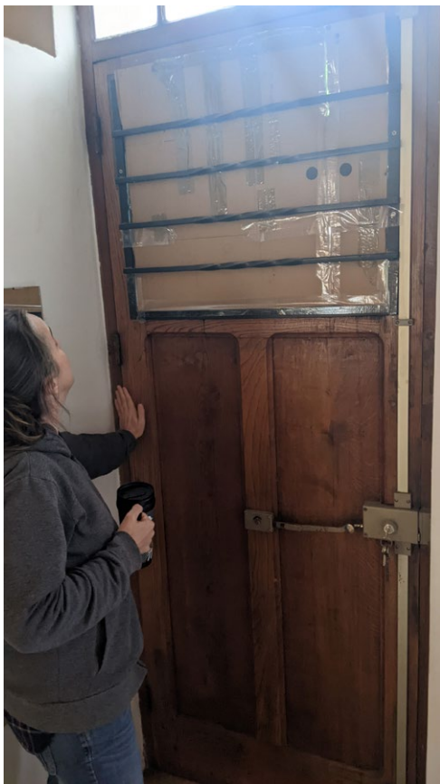
Des fuites d'air qui disqualifient l'aération hivernale
