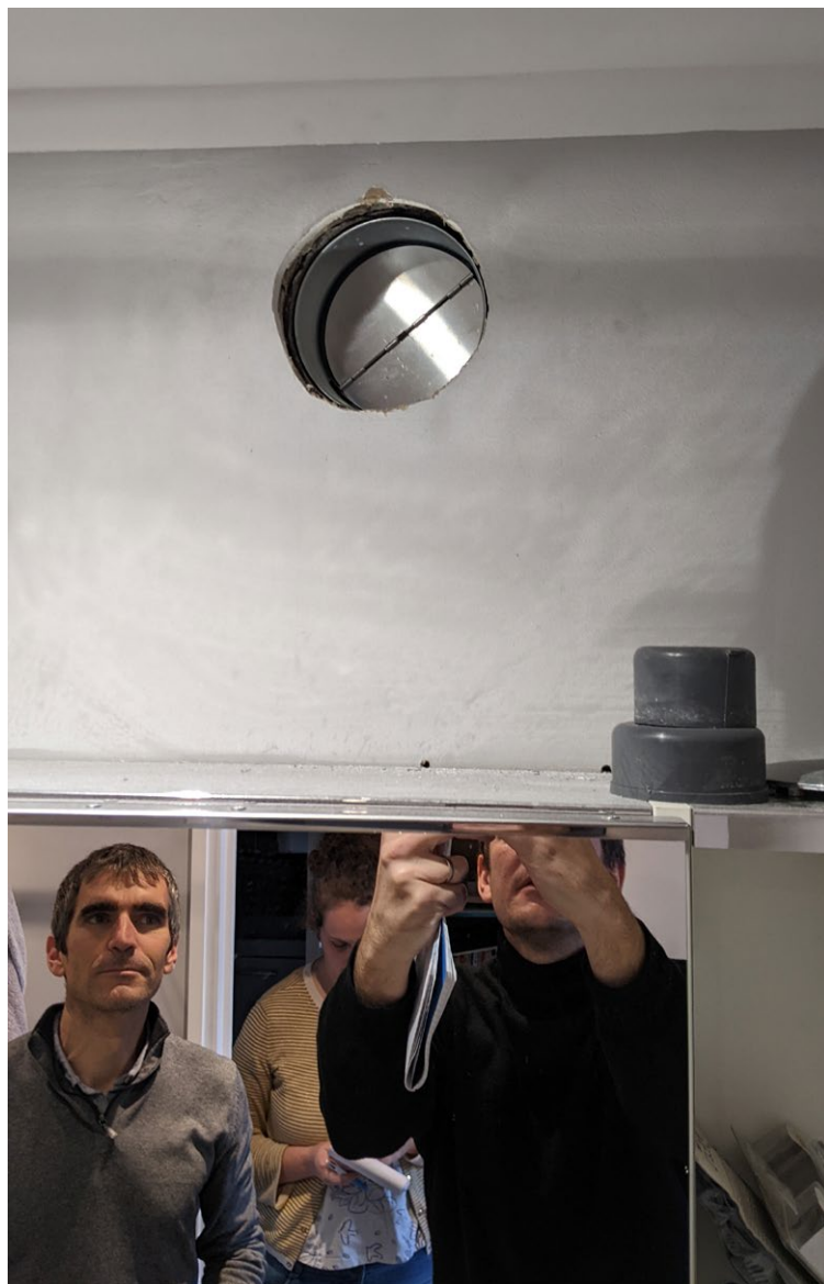
Bouche de ventilation obstruée par un clapet anti-retour bricolé
