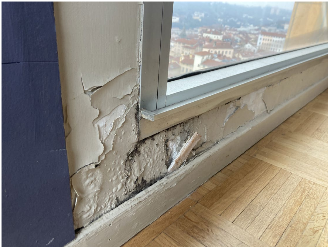
Un pont thermique qui a créé de la moisissure
