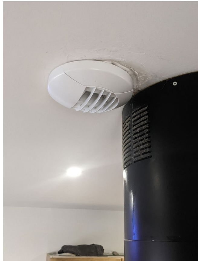
Une hotte en concurrence avec la ventilation
