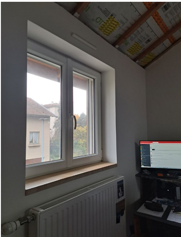
Une entrée d'air au-dessus de la fenêtre plutôt que dans la fenêtre
