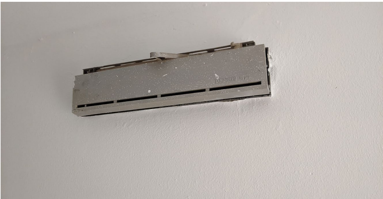
Une entrée d'air qui mériterait un remplacement
