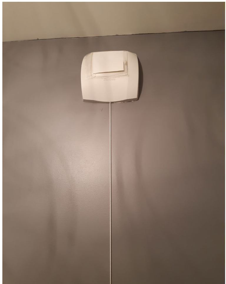
La VMC bouchée dans les toilettes
