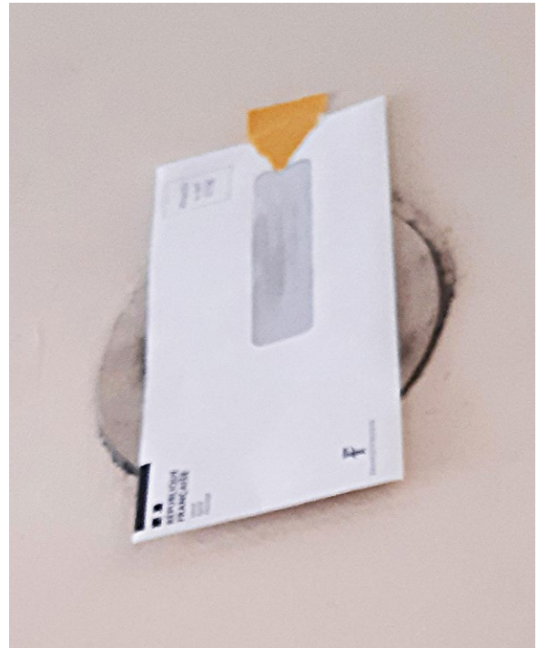
Une bouche obstruée par une simple feuille
