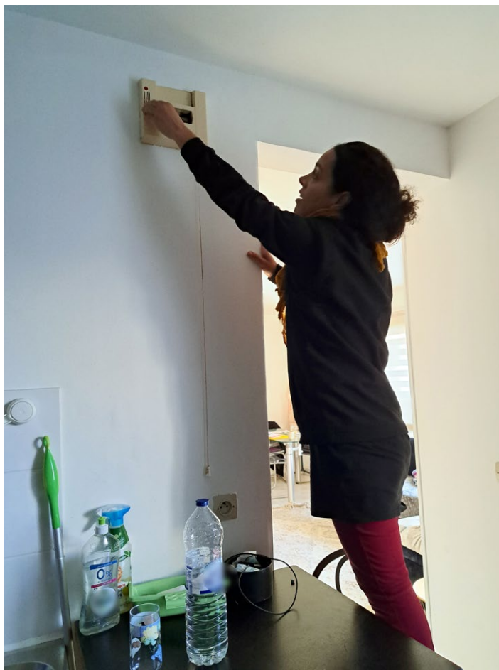
Tentative infructueuse de démontage d'une bouche
