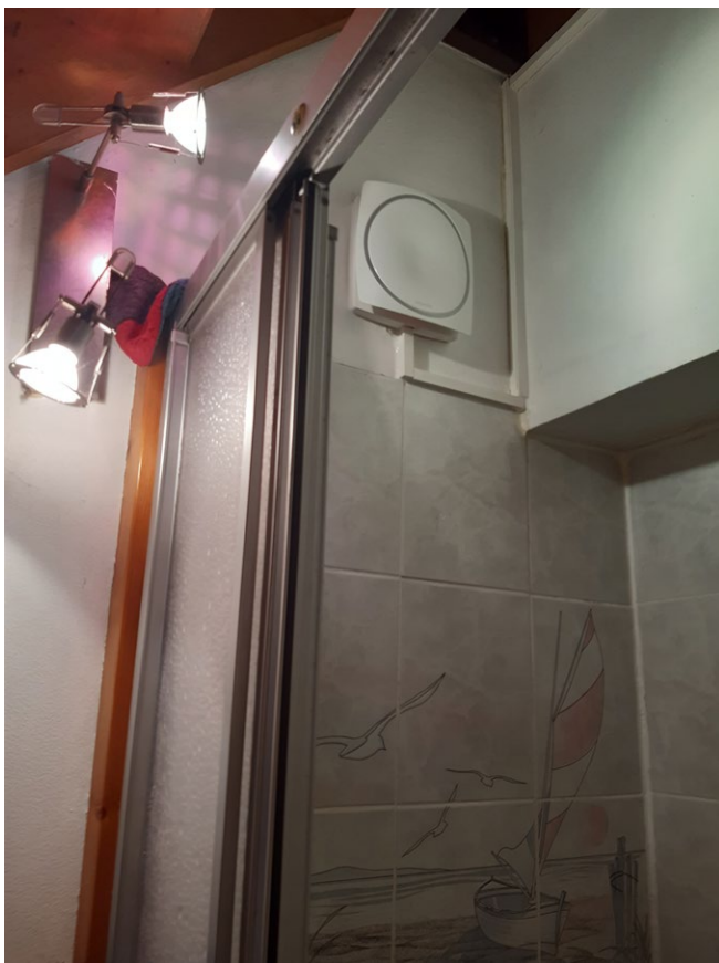
Un extracteur d'air dans la salle de bains moins efficace qu'une VMC
