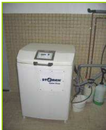
Le COLORFREE (Station de traitement)
