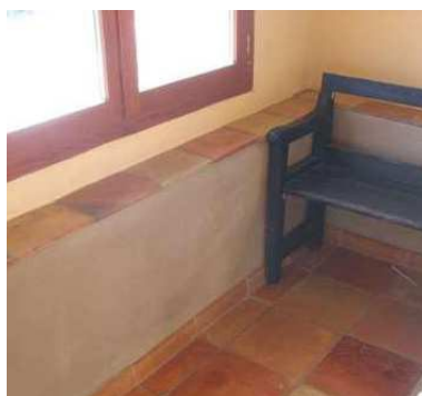
Muret chauffant à l'intérieur de l'extension de la maison A
