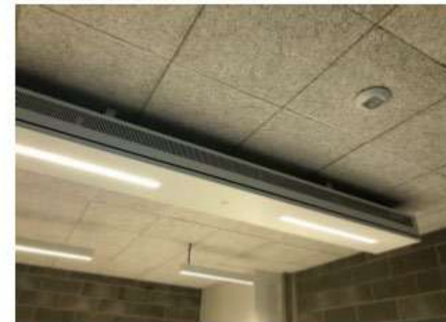
Poutre d'insufflation et bouche d'extraction
