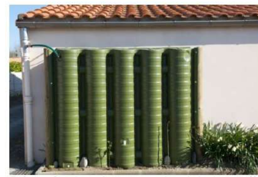
Récupération des eaux de pluie https://www.ecoleaumur.com
