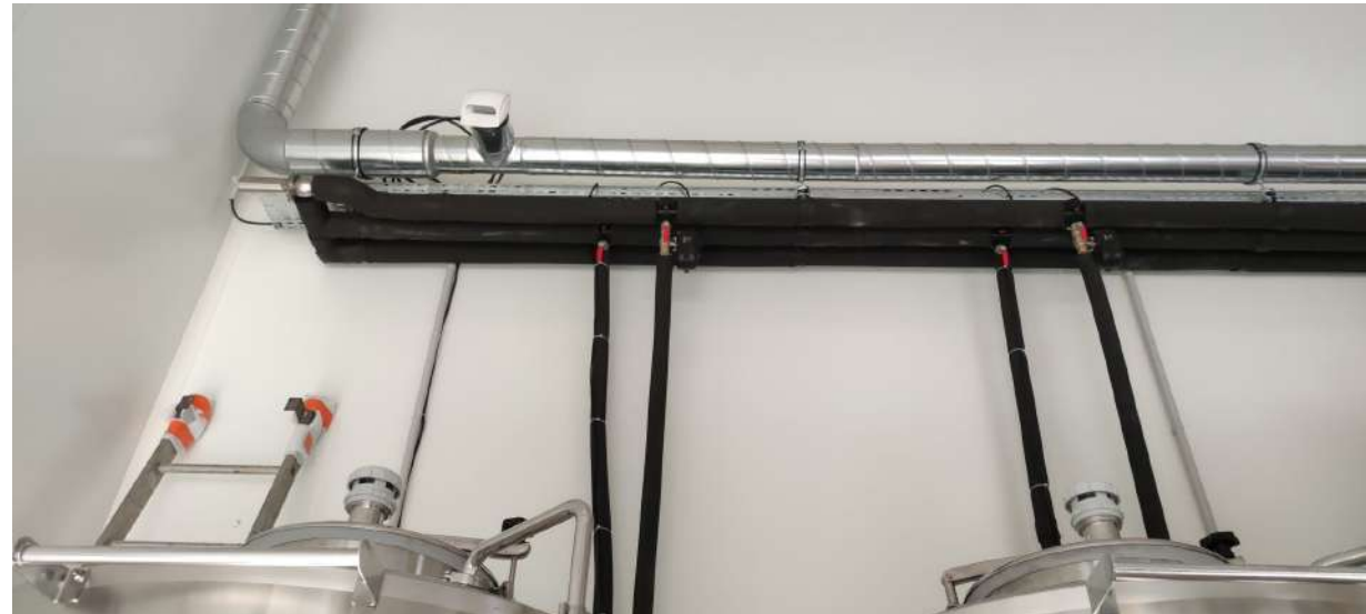
Brasserie Circuit refroidissement
