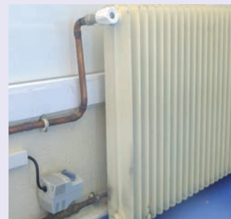
1 électrovanne par radiateur ou par ensemble de radiateurs
