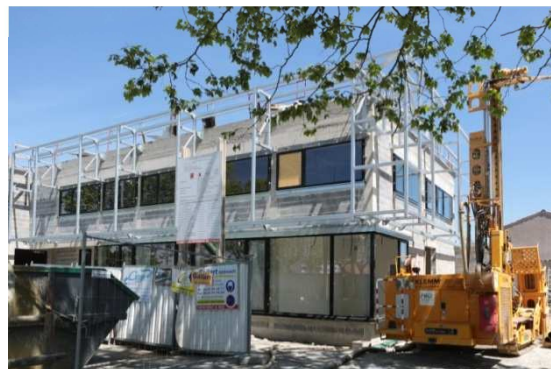
Pose des armatures sur la façade pour la mise en place du bardage.
