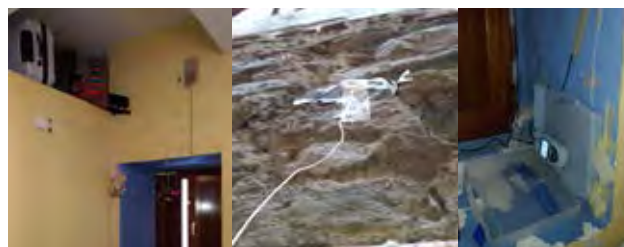
Fluxmètre et sonde superficielle de température intérieure (à gauche), sonde de température de surface extérieure (au centre) et enregistreur de données (à droite).
