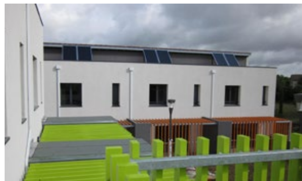
Panneaux solaires thermiques intégrés dans la toiture en «demi-toit» - Photo © ADEME
