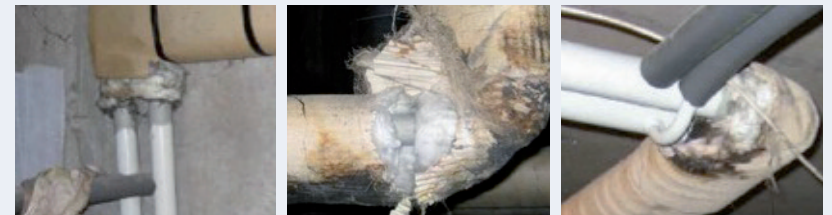
Figure 15 : Exemples de calorifuges non satisfaisants
