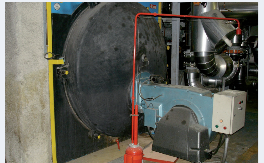
Figure 22 : Vue d'une des deux chaudières fioul
