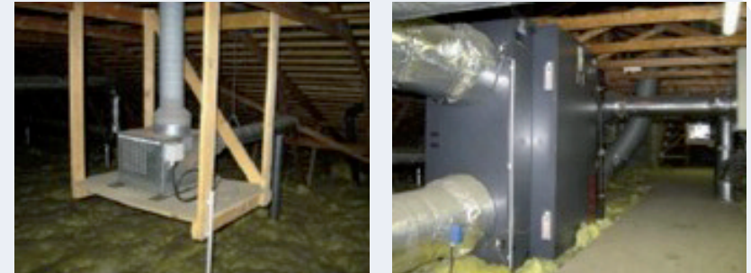
Figure 35 : Vue des caissons d'extraction et de la Centrale de Traitement d'Air
