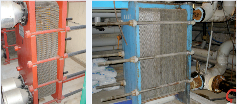
Figure 23 : Vues des échangeurs des circuits eau chaude et eau glacée de la sous-station
