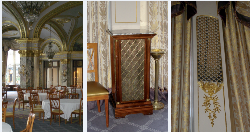
Figure 27 : Vues de la salle Empire et des dispositifs de soufflage/reprise d'air (côté zone vitrée)
