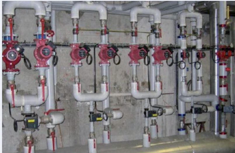
Figure 14 : Nourrice générale et panoplie des 5 circuits de chauffage
