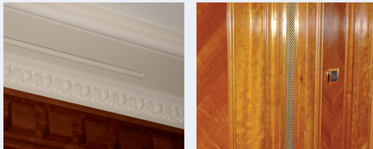
Figure 33 : Vues des dispositifs de soufflage/reprise d'air dans un salon
