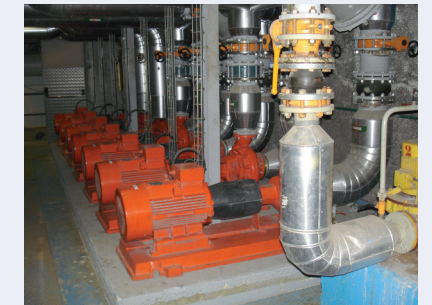
Figure 21 : Vue des pompes réseau primaires
