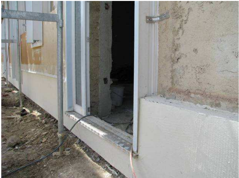
Traitement des seuils de portes avec protection de l'isolant par de la tôle à larmes.
