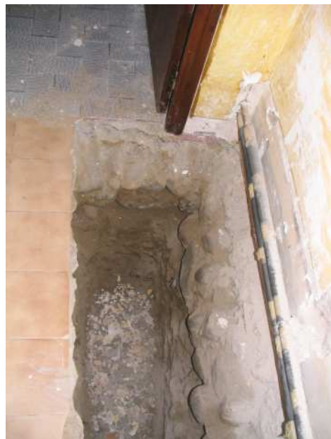
La dalle de ciment et carrelage réalisée sur l'ancien dallage de terre cuite posé sur un lit de chaux est heureusement dépourvue de film plastique. Il ne sera donc pas indispensable de casser cette dalle pour éviter les remontées d'humidité dans les murs.
