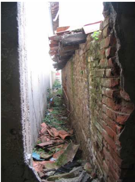
A l'arrière du bâtiment le sol est plus haut que la dalle intérieure. Des gravats l'encombrent.
