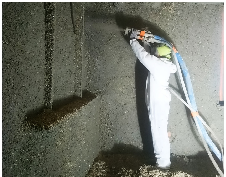
Projection mécanique du béton de chanvre comme correcteur thermique Photo : Matthieu BELCOUR
