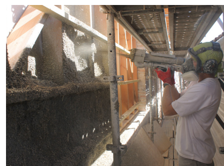
Projection mécanique du béton de chanvre sur l'ossature bois du dernier niveau - Photo : Matthieu BELCOUR
